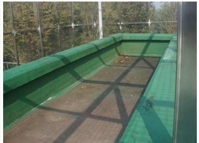
건축물 옥상층 체수흔적
