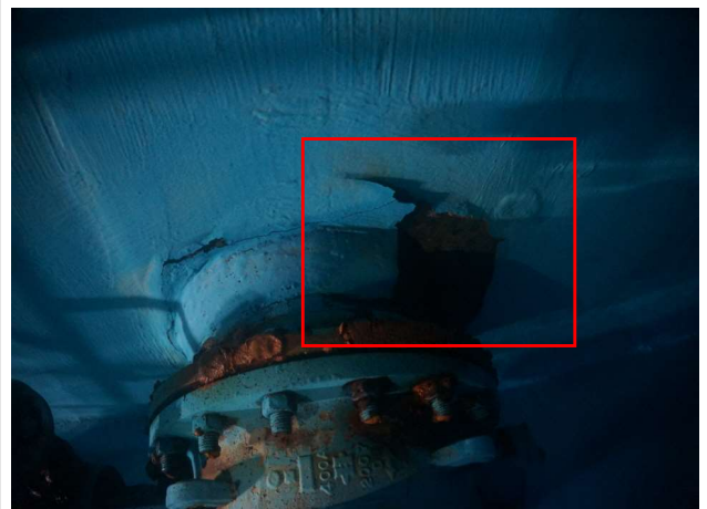
배수지1지 벽체 마감 모르타르 탈락
