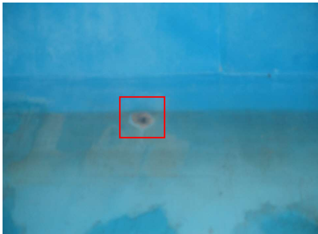
배수지1지 벽체 철근노출
