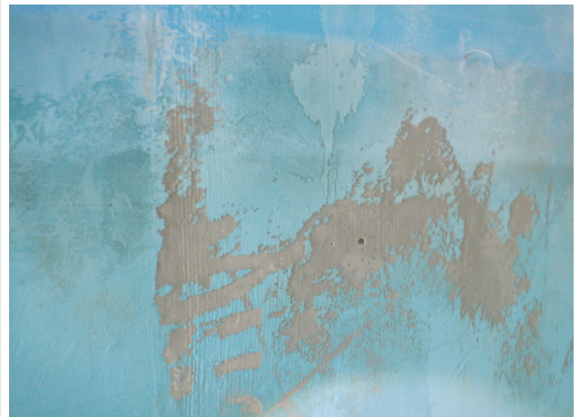
배수지2지 벽체 방수도막박리
