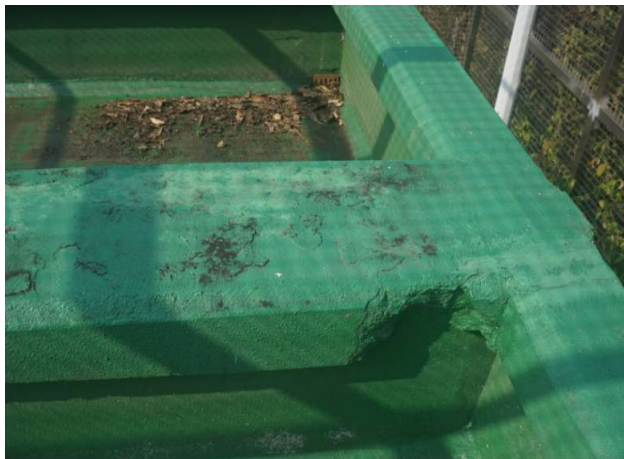
건축물 옥상층 파손
