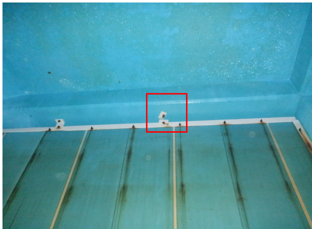
배수지2지 도류벽 브라켓 파손
