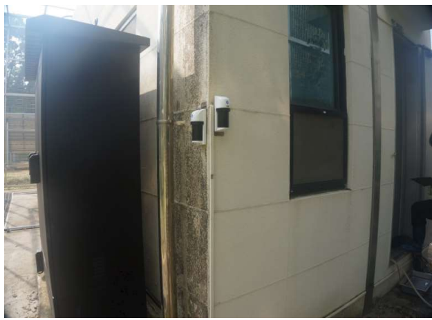
건축물 외부 누수흔적
