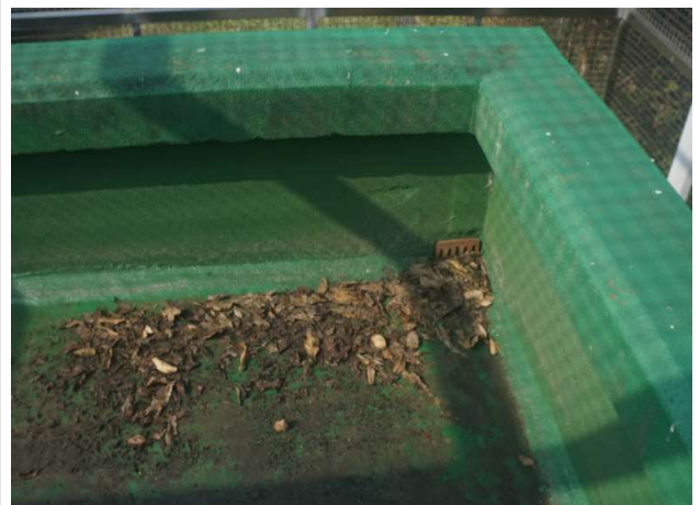
건축물 옥상 배수로 막힘
