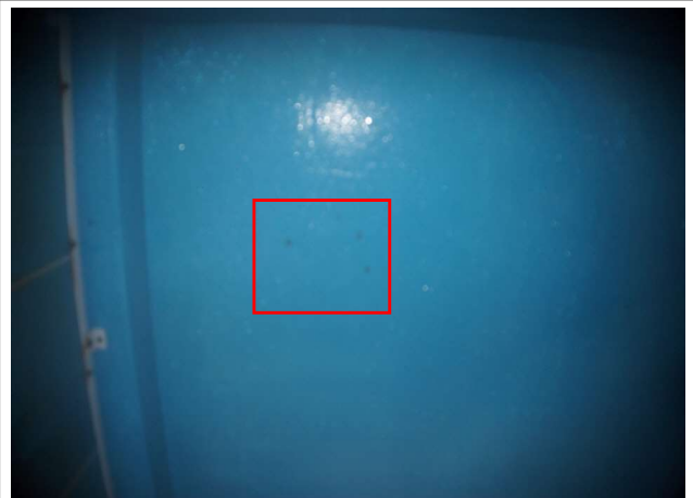
배수지1지 상부슬래브 녹물(부식)
